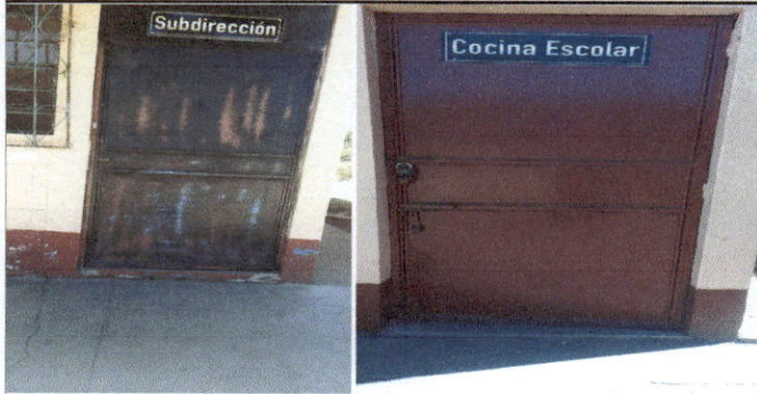
Foto 1. Las puertas estan deterioradas.
